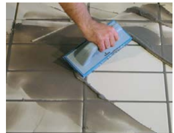
Procedere al riempimento delle giunture, trascorso un intervallo di 4-12 ore dalla posa.
