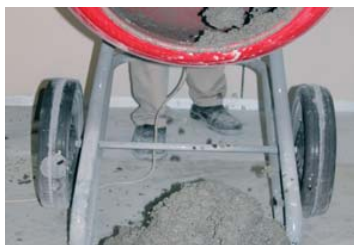
Mortero con aspecto de "arena mojada"
