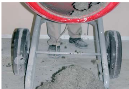
Mortier à l'aspect de « sable mouillé »
