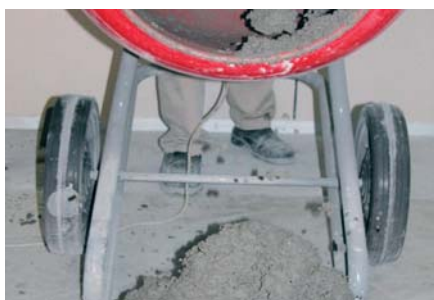
Argamassa com aspecto de "areia molhada"
