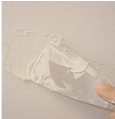
Boucher toutes les fissures et les trous, et lisser à l'aide d'une spatule.
