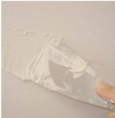
Espatular i re-omplir totes les esquerdes i forats.
