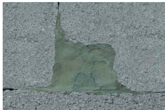
Expande sellando la fisura.
