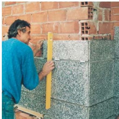
Pegado directo a obra sin enfoscar previamente
