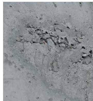
Reparar nidos de grava en el hormigón.
